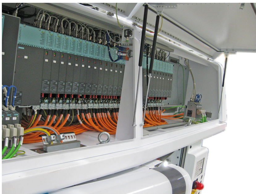
Beispiel: Schaltschranktüren an einer Mehrspindel- Drehmaschine
