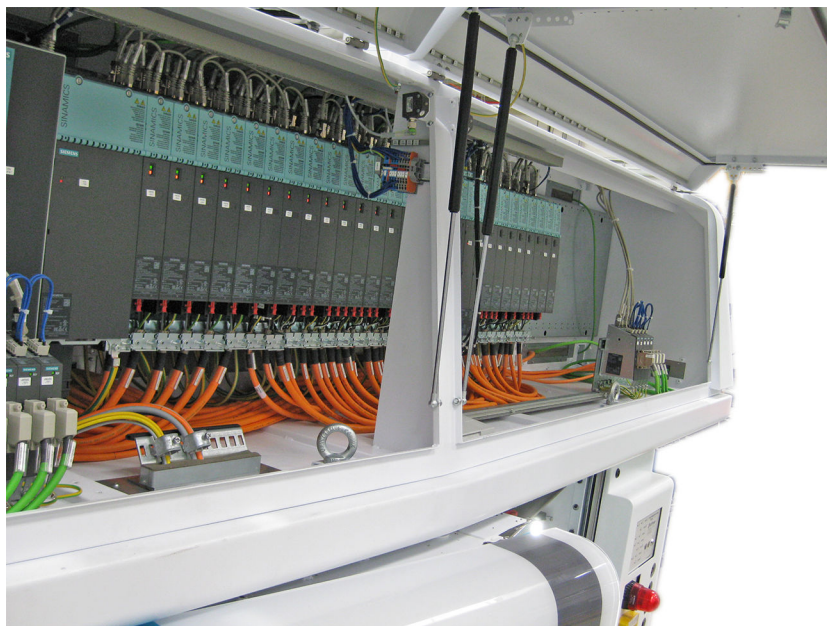
Exemple : Portes de l'armoire électrique d'un tour automatique multibroches
