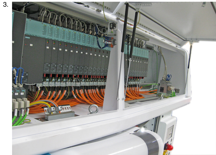
Exemple : Portes de l'armoire électrique d'un tour automatique multibroches
