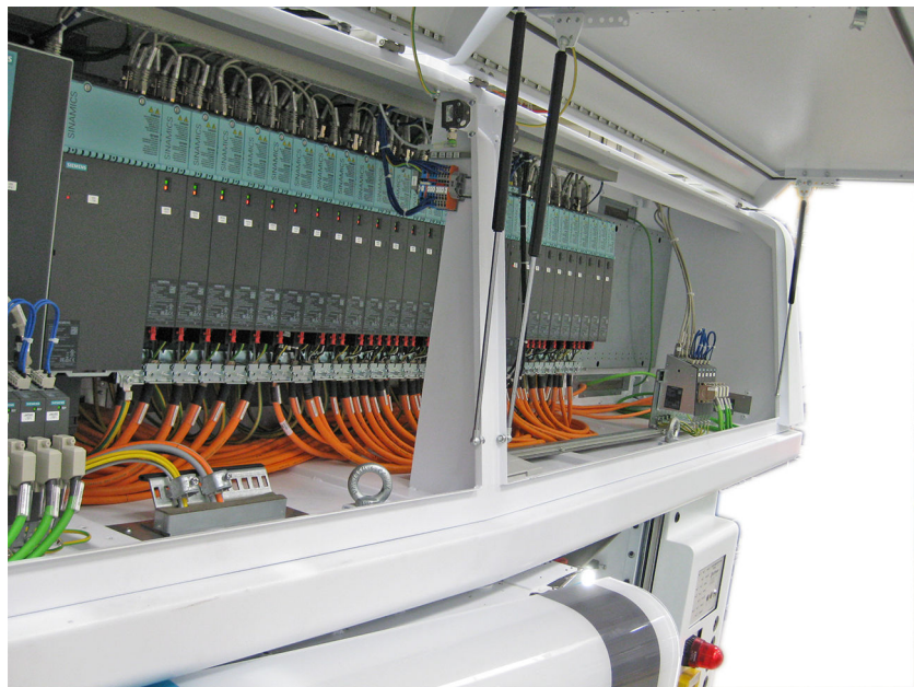
Beispiel: Schaltschranktüren an einer Mehrspindel- Drehmaschine
