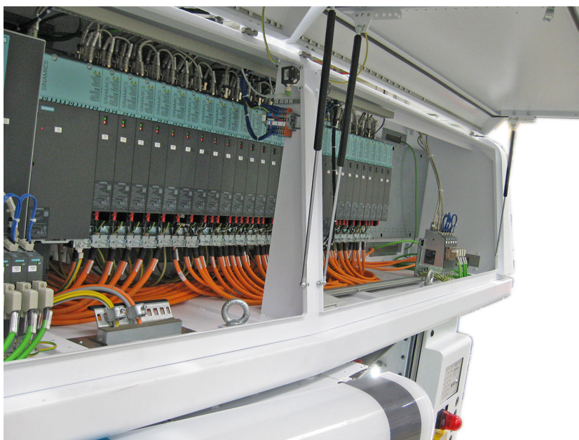
Beispiel: Schaltschranktüren an einer Mehrspindel- Drehmaschine
